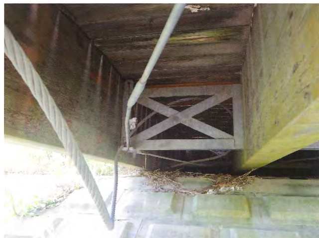
写真-44 田渡橋の桁下のロープ (H30 (2018))
