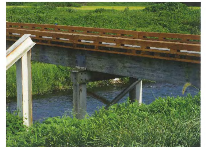
写真-46 白羽橋の桁下のロープ (H30 (2018))
